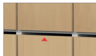
■ ANTA FESSURA PER DOCUMENTI
